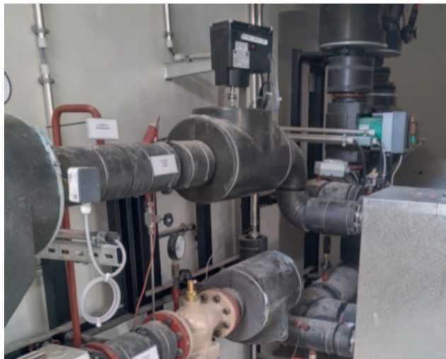
33: Fernwärmeübergabestation im hessischen Landtag
